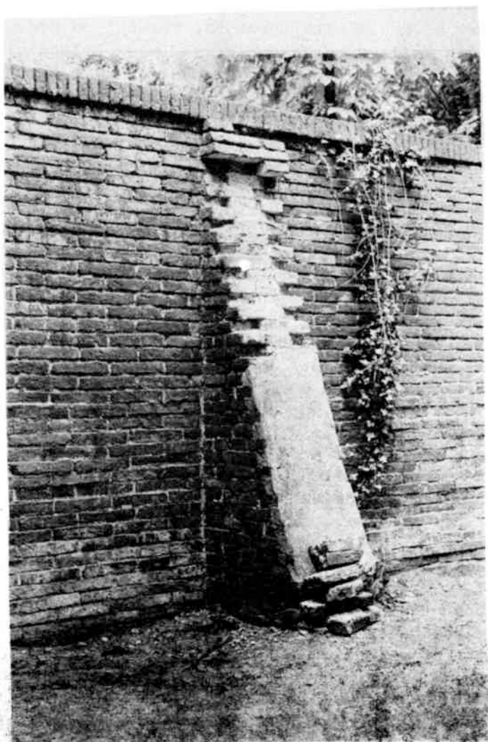
De muur is duidelijk aan herstel toe! (foto J.v.d.Sar, juli 1982)
