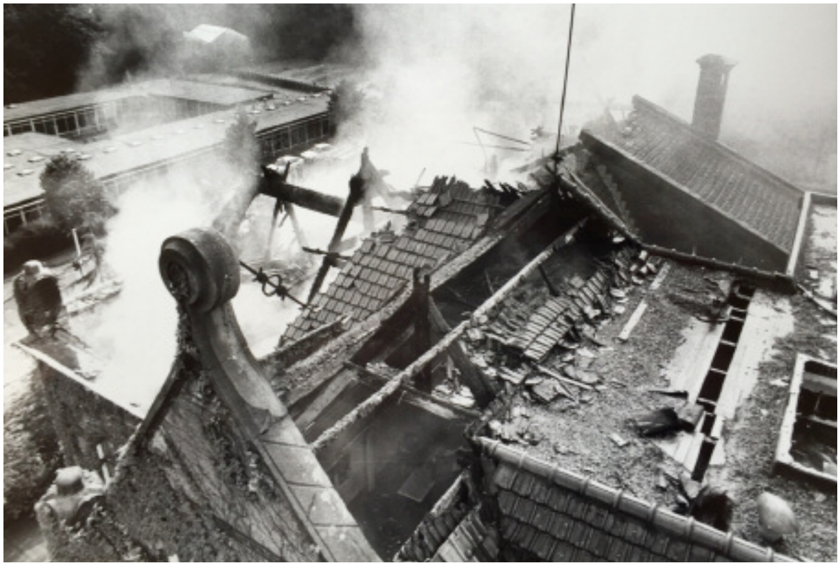
Het dak van bovenaf, gezien vanaf de voorgevel. Links op de achtergrond zijn de noodlokalen van de school aan de zijde van de Jonkerweg. (Foto Ton Kastermans)
